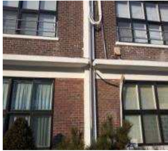
누수 보수 공사(파라펫 제거 공사) 전
