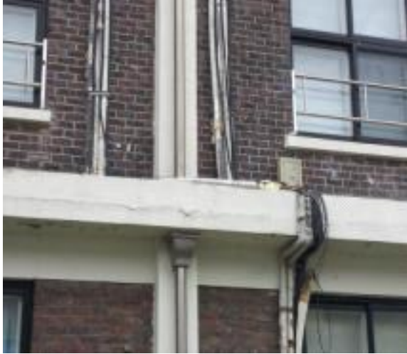
누수 보수 공사(파라펫 제거 공사) 전
